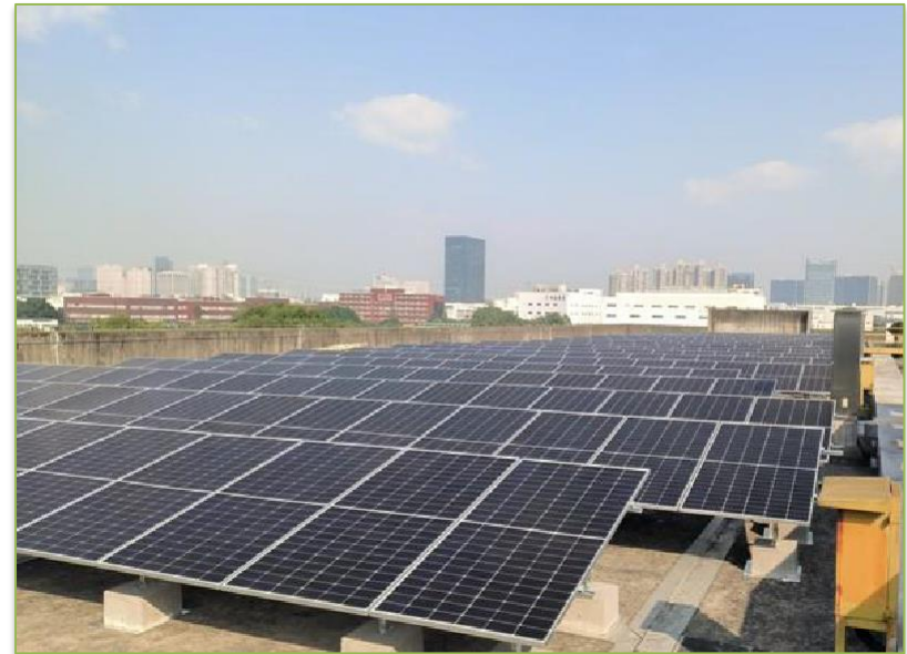
太陽光発電設備
