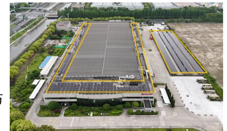
Dynabook Technology (Hangzhou) Inc.の太陽光発電設備
