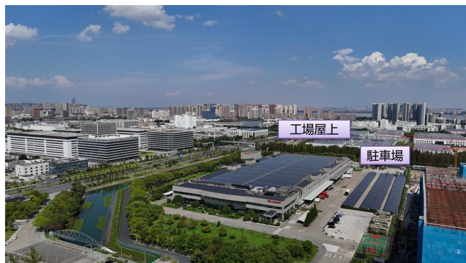
太陽光発電設備
